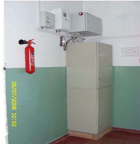
в) с. Олександрівка ППК-9 (радіошафа, пульт пожежної сигналізації, щиток розподільний, шафа системи безперебійного живлення, грозозахист)
