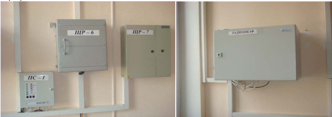
г) щити пожежної сигналізації ПС-1, енергопостачання та оптоволоконного зв'язку ЩР-7, щит розподільний ЩР-6
