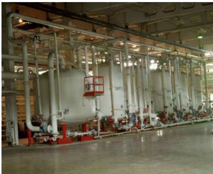
Центральний зал хімоводоочищення
